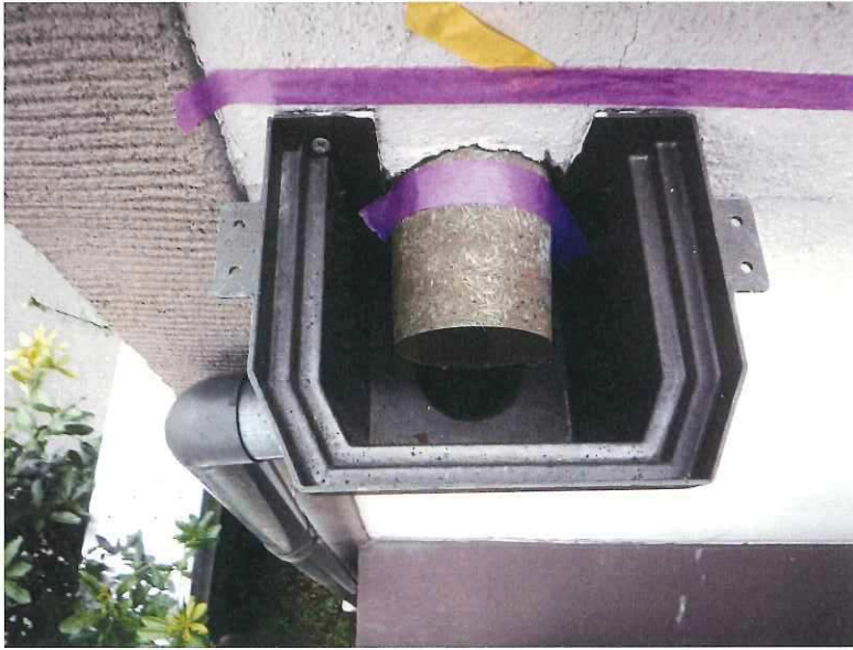
NO. 2 雨水ドレン
