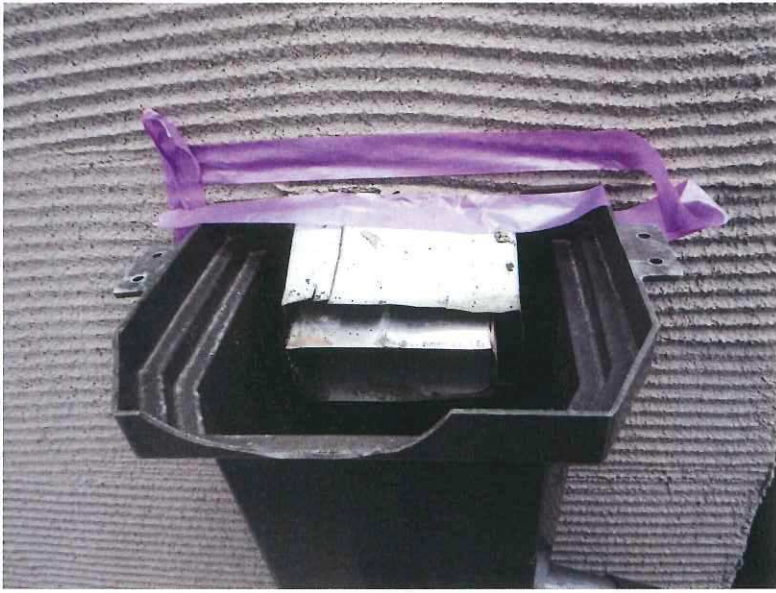
NO. 4 雨水ドレン
