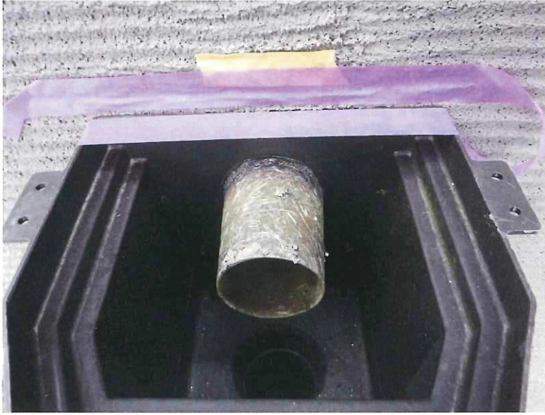
NO. 3 雨水ドレン
